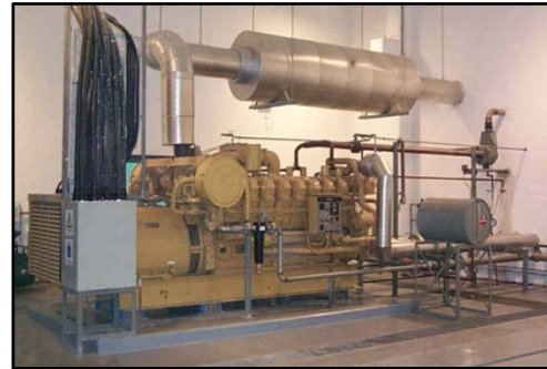
堆填氣體發電機
